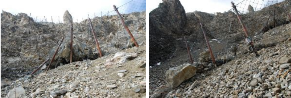
Abb. 4a und 4b: Beschädigte Schneenetze (links) und verschüttetes Bohrloch (rechts) oberhalb von Arolla, VS (Fotos: SLF/M. Phillips, 06.09.2012).
