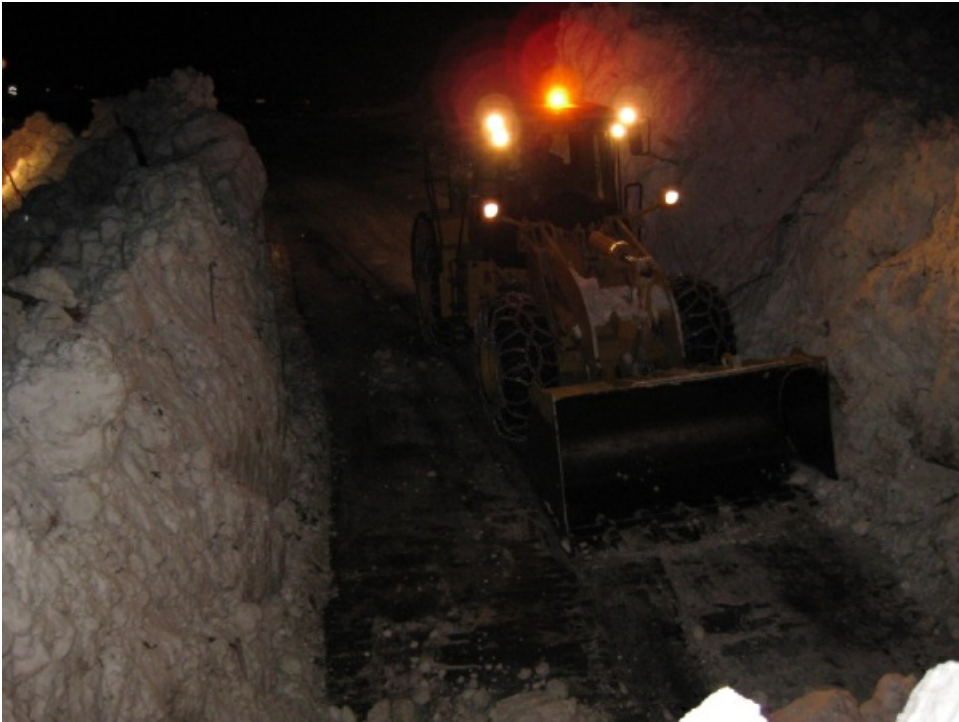
Nach dem Lawinenabgang um ca. 15 Uhr am Freitag, 06.03. blieb die Passstrasse zum Grossen St. Bernhard wegen Räumungsarbeiten bis Samstag Morgen gesperrt. Die Ablagerungen auf der Strasse waren bis zu 4 m hoch (Foto: E. Berclaz, 06.03.2009).
