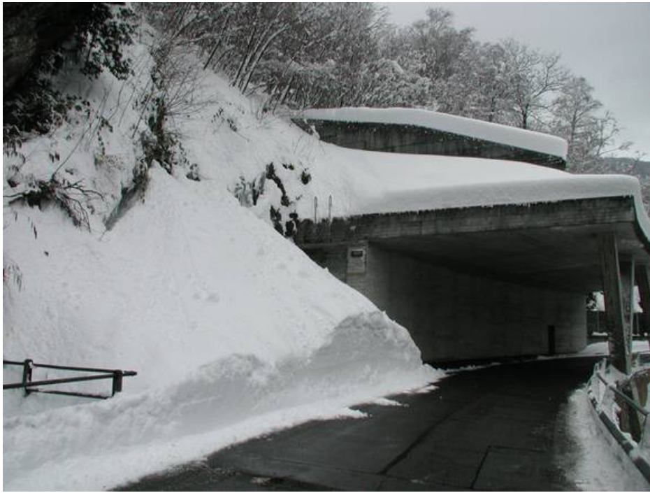
Photo 7: Route de la vallée de Calanca entre le tunnel de Val d'Infern et la Ponte Calancasca (GR). Ce glissement a atteint la route, qui avait été préalablement fermée, dès le vendredi après-midi 27 janvier (photo: S. Fehler, 31.01.2006).
