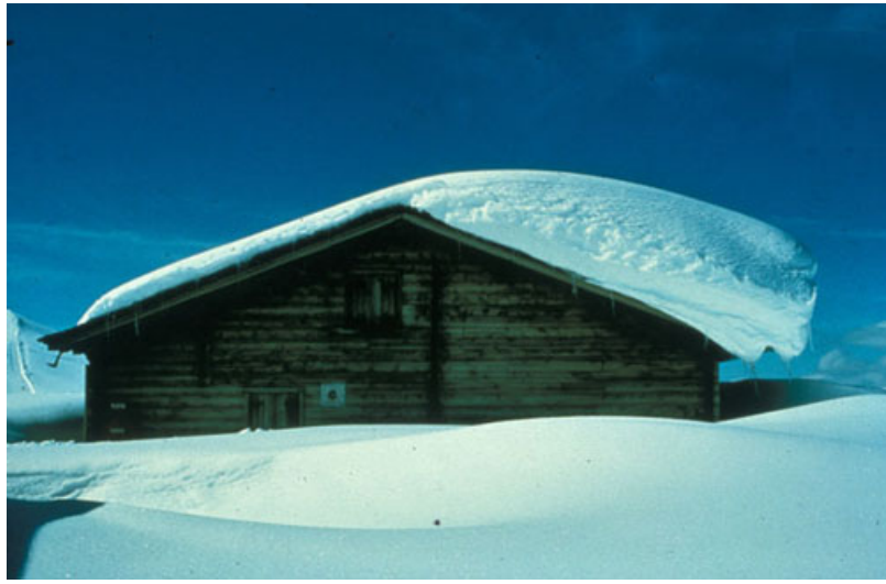
Abb. 5: Ungleichmässige Schneeablagerung auf einem Hausdach. Der Wind kam hier von links (Luv) und blies den Schnee nach rechts (Lee), wo er sich ablagerte, weil die Schleppkraft des Windes kleiner wurde. (Foto: Sievi Gliott, SLF).
