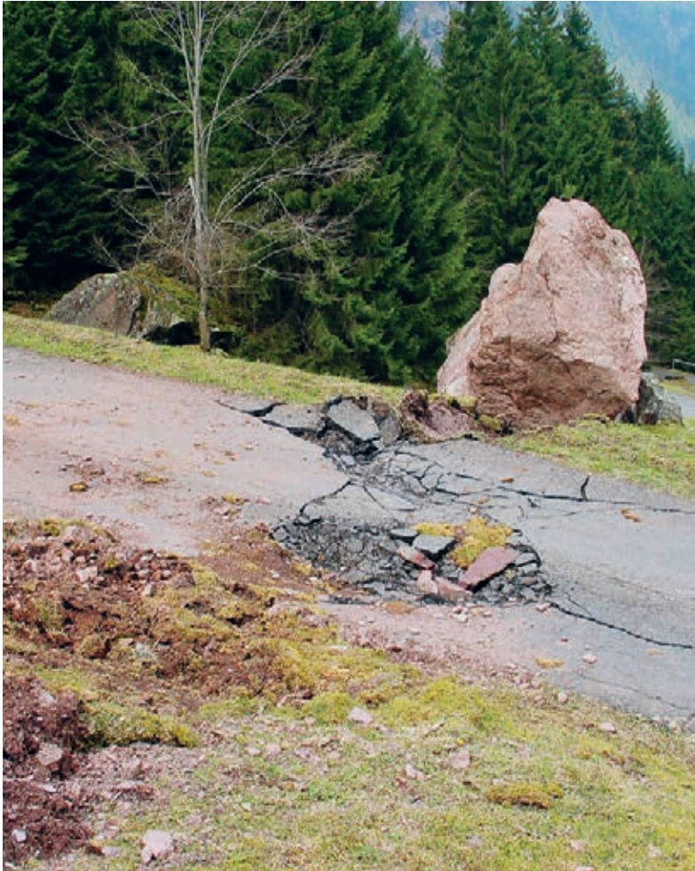
Ein 125-Tonnen-Steinkoloss beschädigte im April 2005 im Murgtal Wald und Strasse, welche darauf aus Sicherheitsgründen gesperrt werden musste. Die WSL hat unter anderem dieses Ereignis genutzt, um ihre Simulationssoftware «RAMMS::Rockfall» zu testen.
