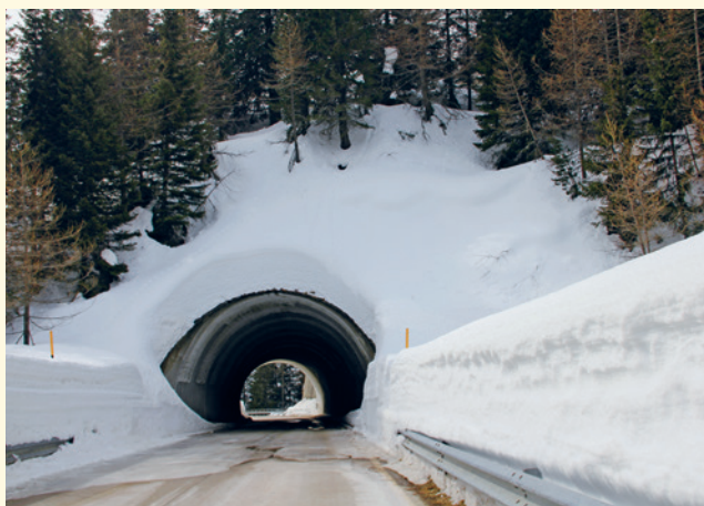
Depuis une forte pente située au-dessus de l'entrée d'un tunnel, la neige peut glisser et tomber sur la route, comme ce fut le cas ici, au col du Lukmanier.
