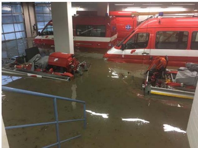
Bild 6. Die Fahrzeughalle der Feuerwehr Frauenfeld TG überschwemmte nach einem heftigen Gewitter am 8. Juni (Foto: www.fwff.ch ).
