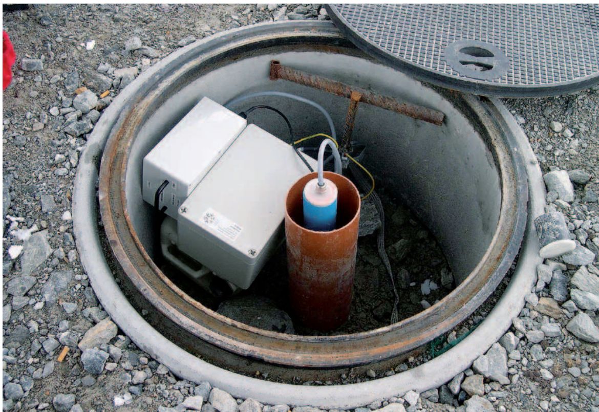
Fig. 35: Puits avec couvercle pour protéger le trou de forage, le tube et les instruments de mesure.
