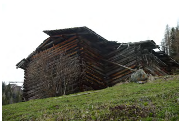
Abbildung 170: Beschädigte Alphütte derselben Lawine (Foto: SLF/M. Phillips, 11.05.2019).
